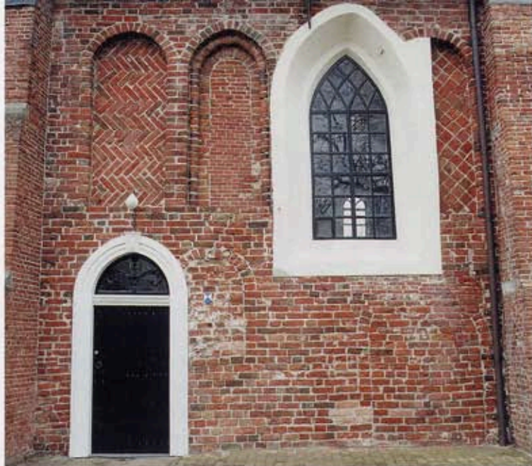
3 De zuidgevel van de kerk in Noordwolde, waar een later ingebroken venster het siermetselwerk niet ongemoeid liet. Ook voor het overige is deze gevel een boeiend bouwhistorisch document.
